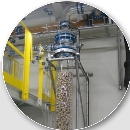
Solvent recovery, packed DN300 column, reflux condenser and controlled reflux divider Lösungsmittel-Rückgewinnung, Füllkörperkolonne DN300, Rückflusskondensator mit Rückflussteller inkl. Regelung
