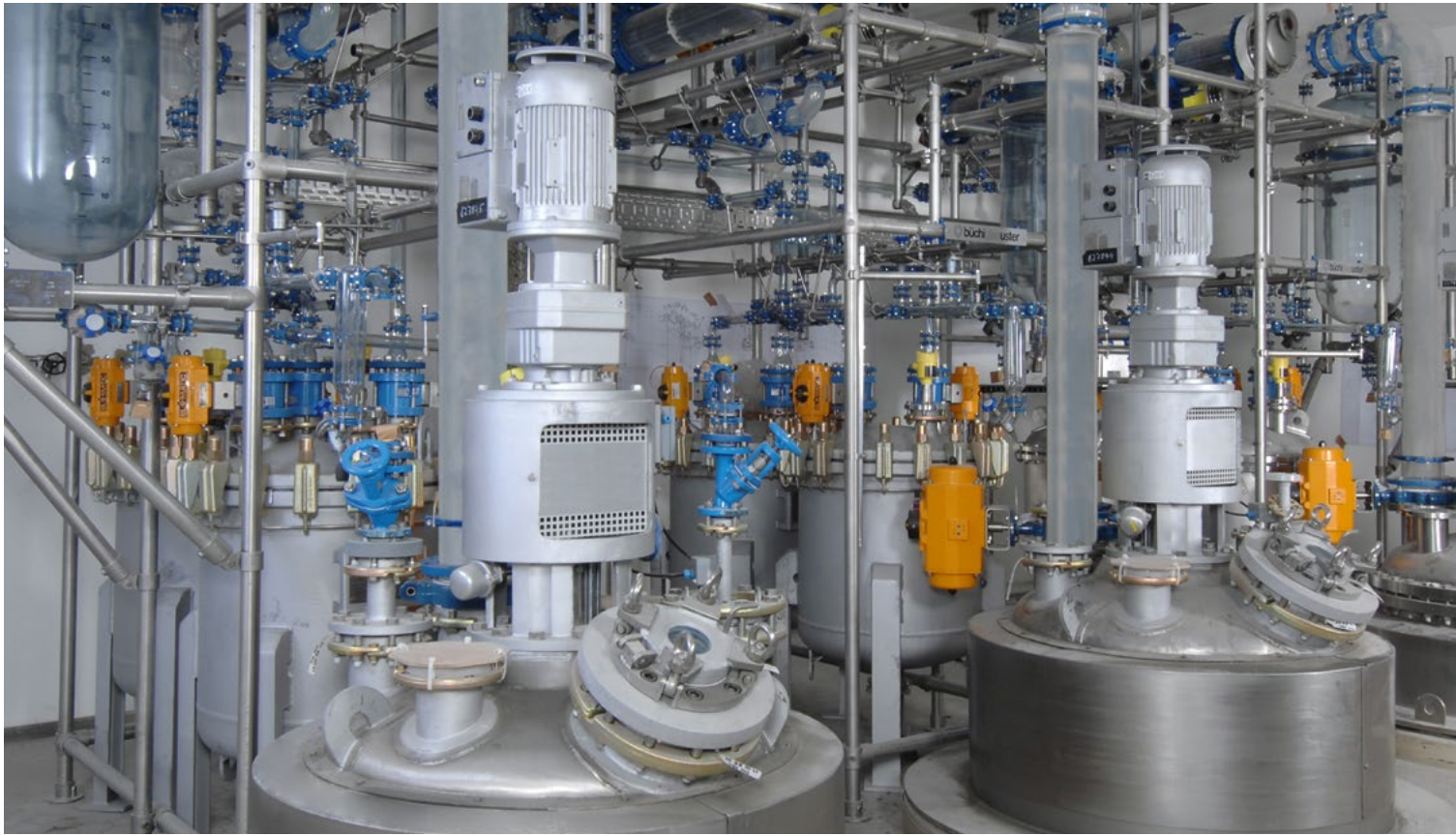
cGMP facility with 800 liter glass lined AE / BE reactors, distillation glass overhead with SiC condensers and glass lined receiver tanks for API production cGMP Anlage mit 800 Liter AE / BE Stahl-Emaillierten Reaktoren, Destillations-Glasaufbau mit SiC Kondensatoren und emaillierten Vorlagegefäßen für API Produktion
